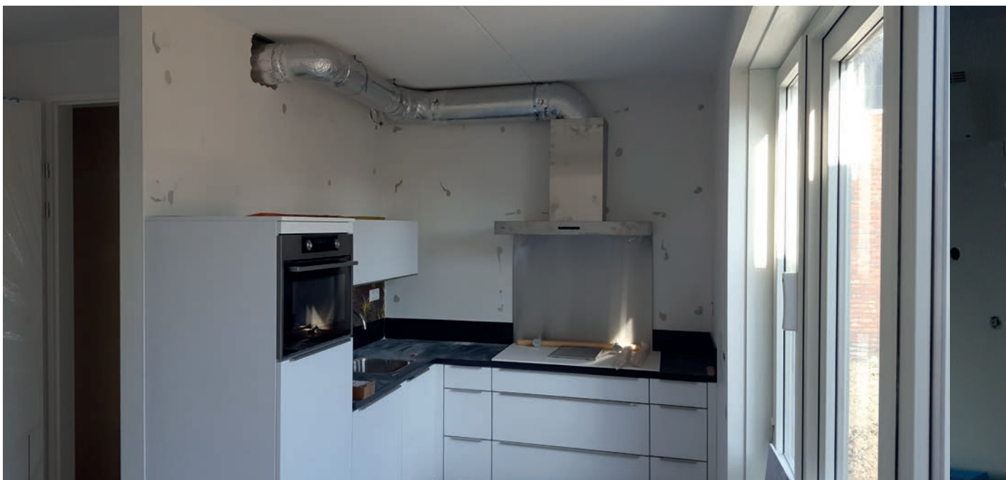
Figuur 3: De motorloze afzuigkap (links) is aangesloten op een 180 mm afvoerkanaal.
